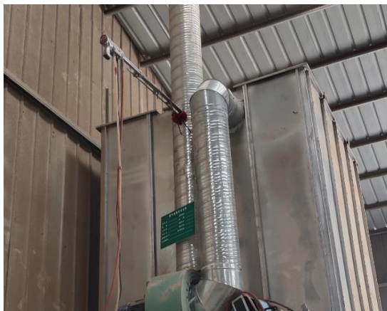
图 4-6 废气排放口标志
