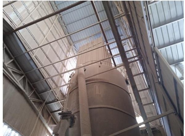
图 4-2 袋式除尘器（南侧料仓）
