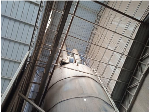
图 4-1 袋式除尘器（北侧料仓）
