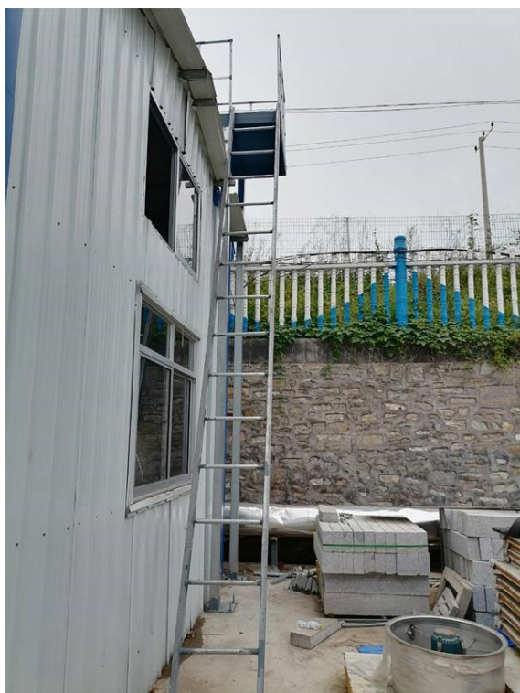
图 4-4 废气采样平台
