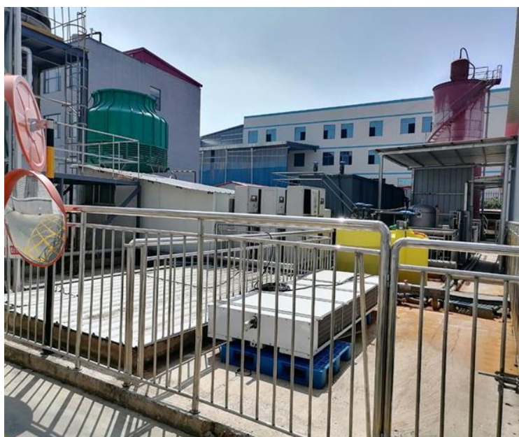
图 3-3 山东汉欧生物科技有限公司污水处理站
