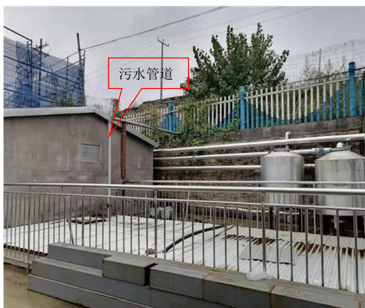
图 3-2 沂南东赐食品有限公司废水收集池和污水污水管道
