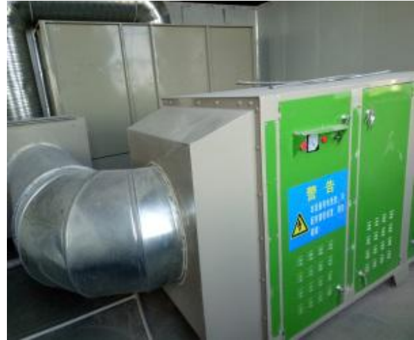
图 4-2 1#喷漆房废气处理设施
