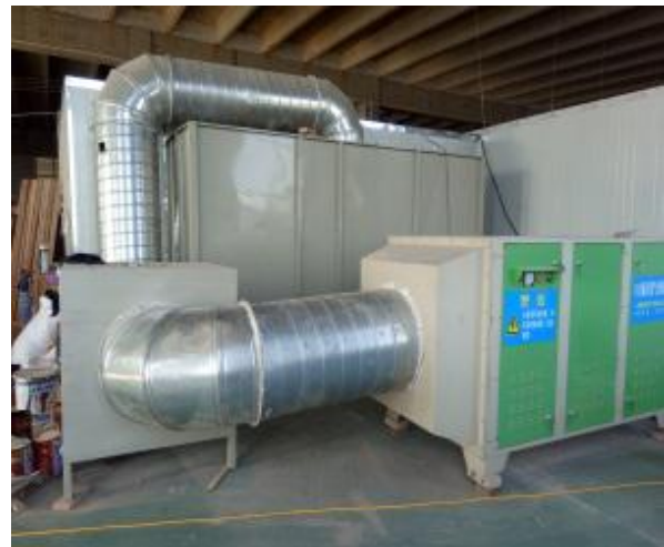
图 4-4 3#喷漆房废气处理设施
