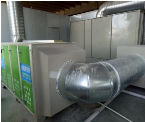
图 4-3 2#喷漆房废气处理设施
